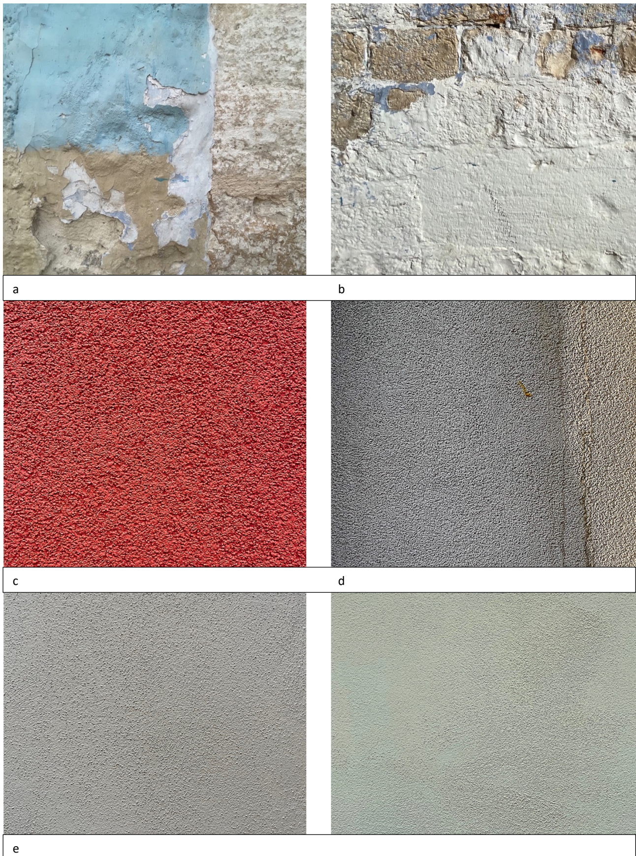
Fig. 1 – Campioni di intonaci: a. Campione di muratura con intonaco liscio a base calce degradato; b. Campione di muratura con intonaco liscio a base calce lavorato a spessore; c. Campione di intonaco moderno a base cementizia grana grossa; d. Campione di intonaco moderno a base cementizia grana più fine; e. Campioni di intonaci moderni a base cementizia a grana fine.
